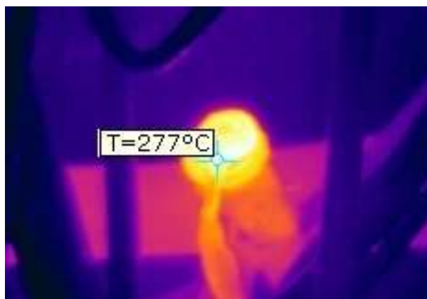
Рисунок 22. Пример обнаружения пожароопасного разогрева болтового контактного соединения
